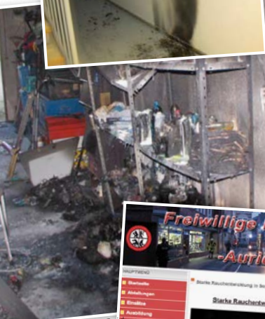
Incendio presso un cliente a P...
