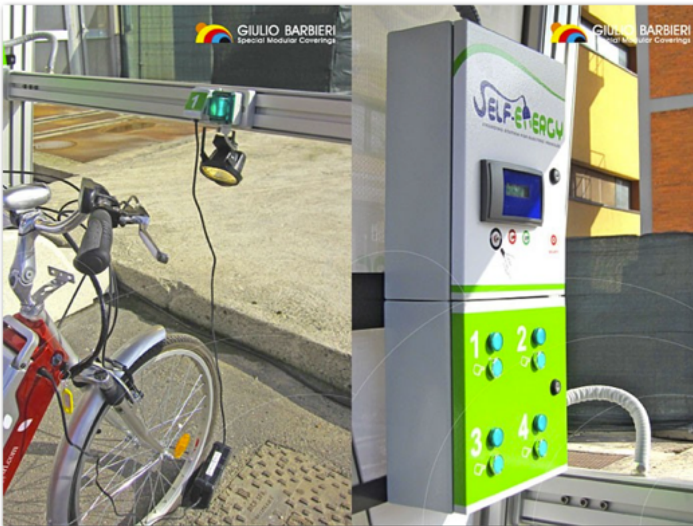
SOLARLADESTATION FÜR ELEKTROFAHRZEUGE SELF-ENERGY - ISPRA (VARESE, ITALIEN) - IET FORSCHUNGSZENTRUM - EUROPÄISCHE KOMMISSION
