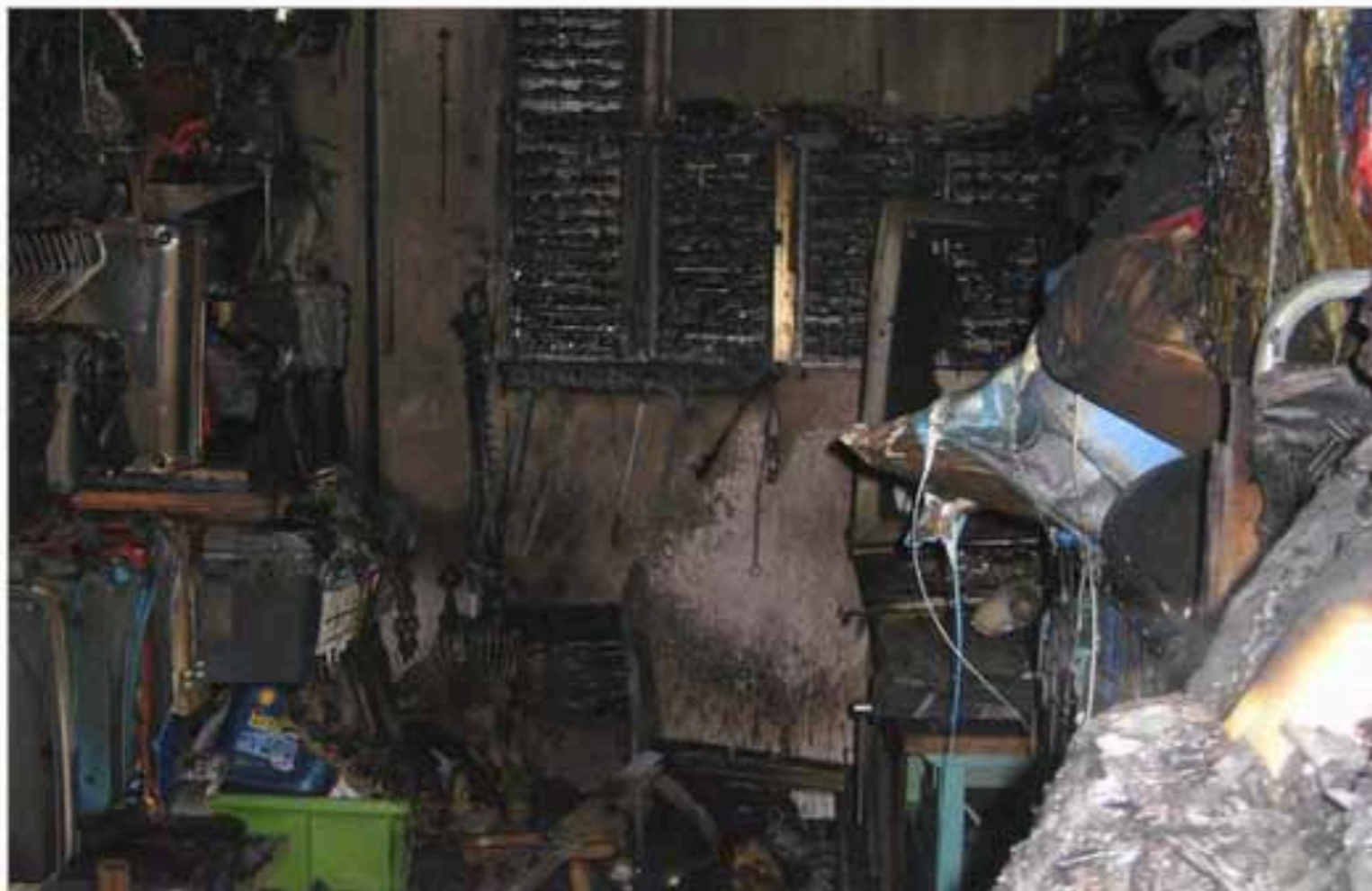
Das ausgebrannte Kellerabteil
