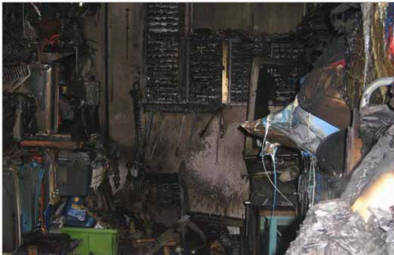
Das ausgebrannte Kellerabteil
