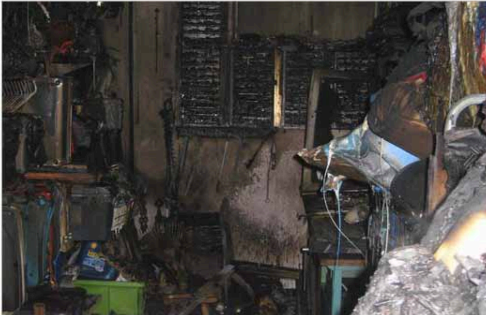
Das ausgebrannte Kellerabteil
